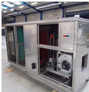
Traitement d'air et climatisation
